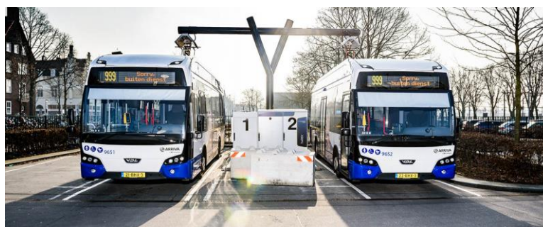
Figuur 3: laadinfrastructuur met transformatorruimte (Foto: Allego.nl)
