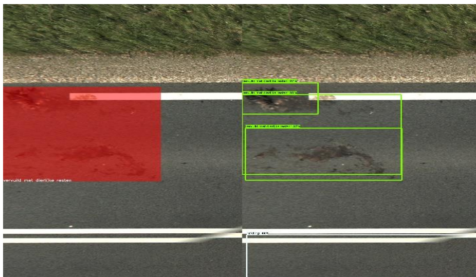
Figuur 2: Beschadigd asfalt dat door het algoritme is aangemerkt
